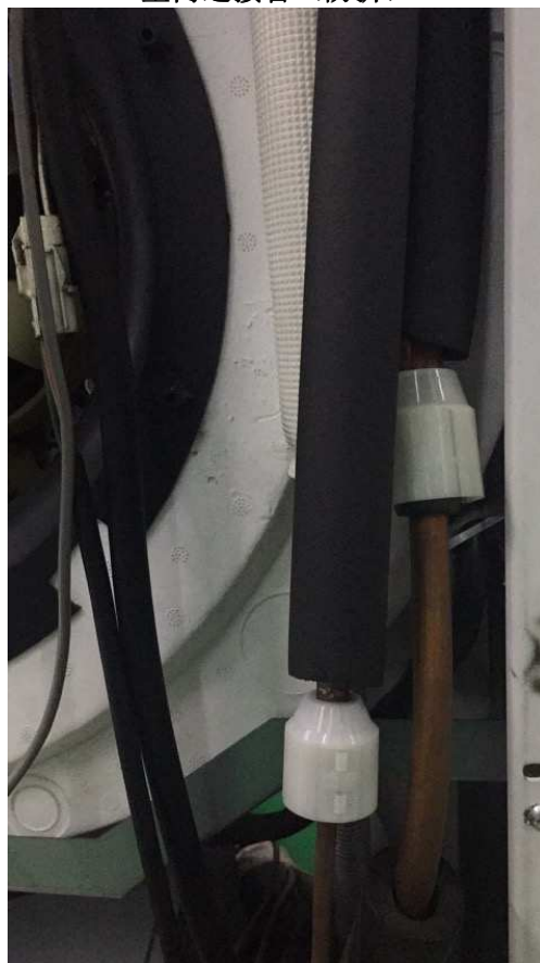
室内连接管 (防拆)
