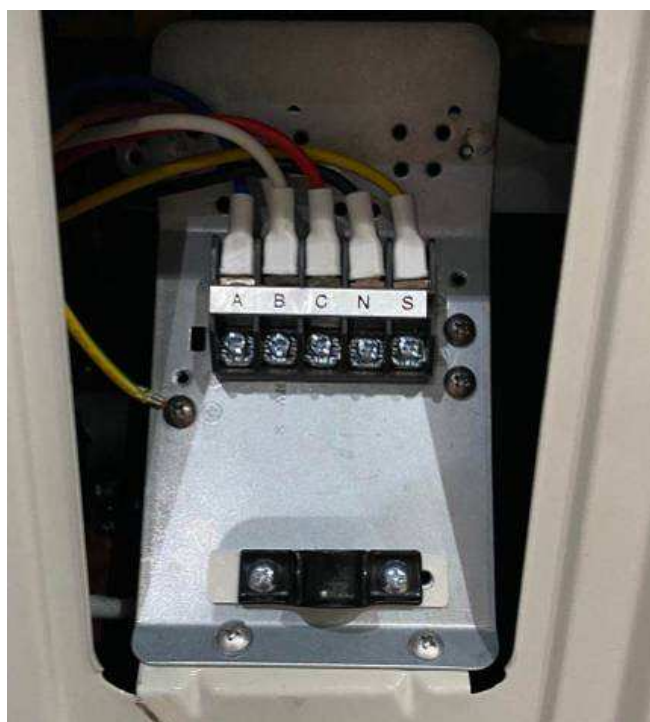
室外机接线端子
